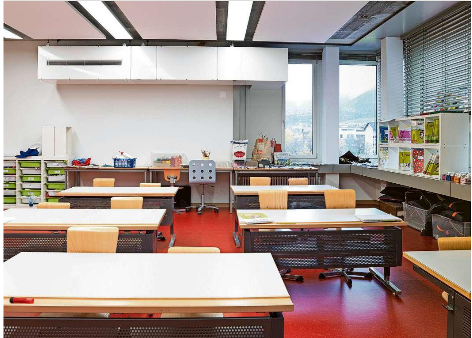
Zwar sichtbar, aber nicht hörbar: Ein im Churer Schulhaus Rheinau montiertes Einzellüftungsgerät.
